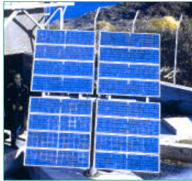
Figura 1 I pannelli fotovoltaici.
