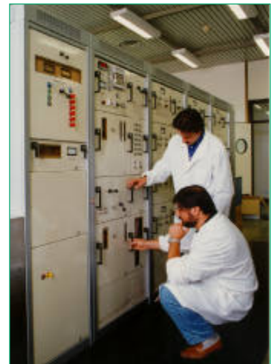
Figura 8 Apparati per l'alimentazione dei sistemi sottomarini.
