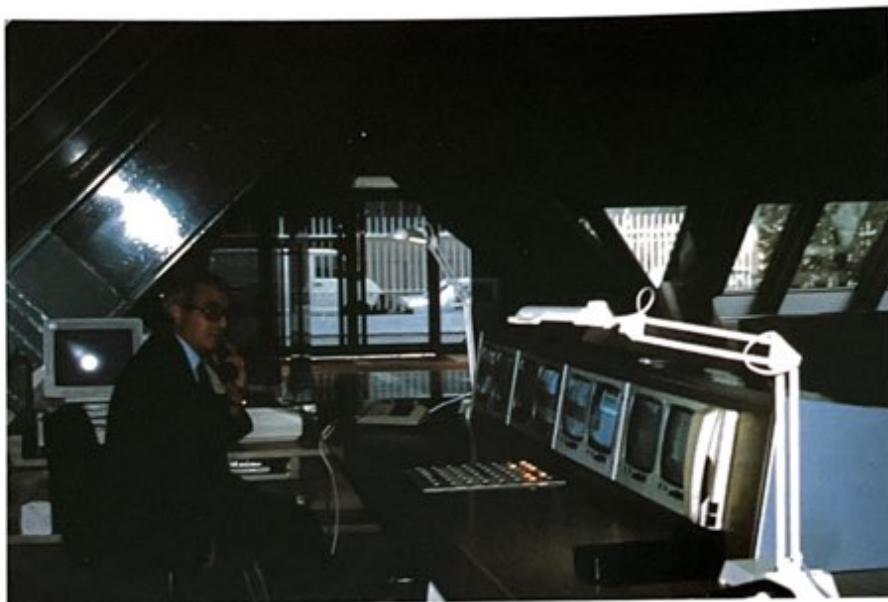
Una delle due «sale operative» da cui si sovrintende alla funzionalità del sistema di supervisione e di tutti i sottosistemi.
