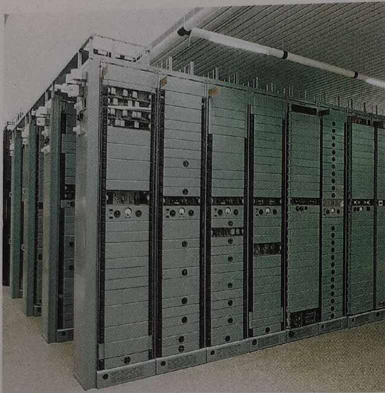
Multiplex di canale Face
