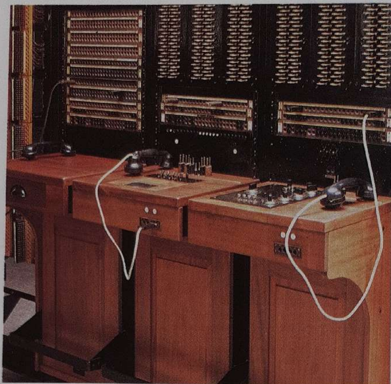
Telai Standard con cassette terminali di cavi a coppie simmetriche (1930)
